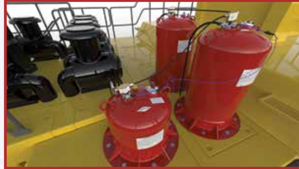
Cilindros de Agente Extintor
