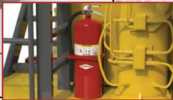
Extintor de Alto Flujo
